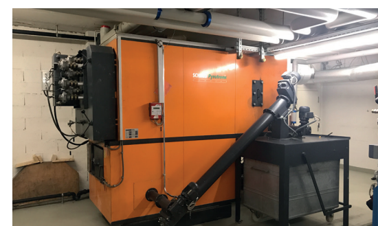
Chaudière Schmid Pyrotronic de 320kW
