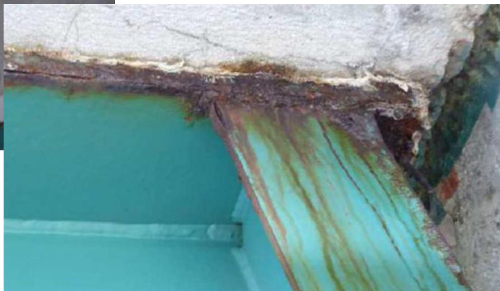
Interface acier-béton corrodée
