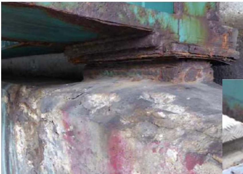
Dégradation appareils d'appui et culées
