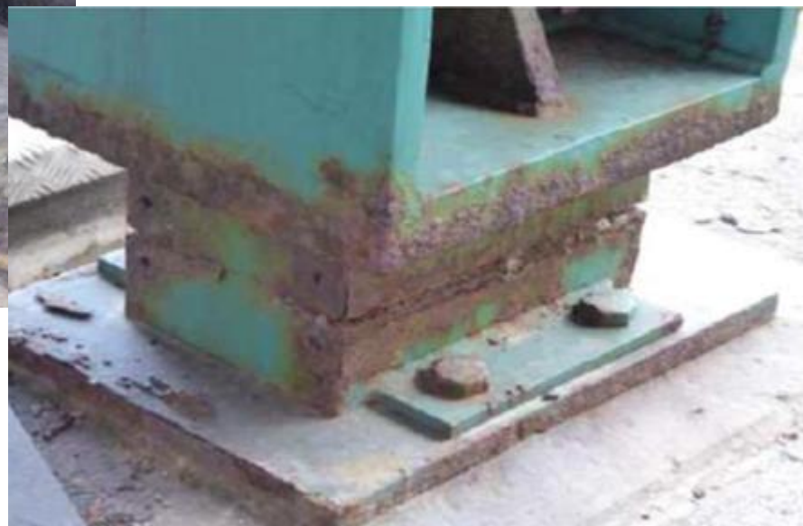
Dégradation appareils d'appui
