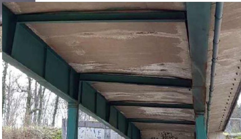
Taches d'humidité – armatures apparentes
