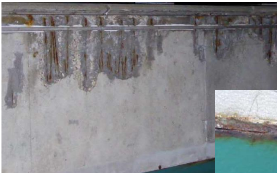
Armatures apparentes corrodées
