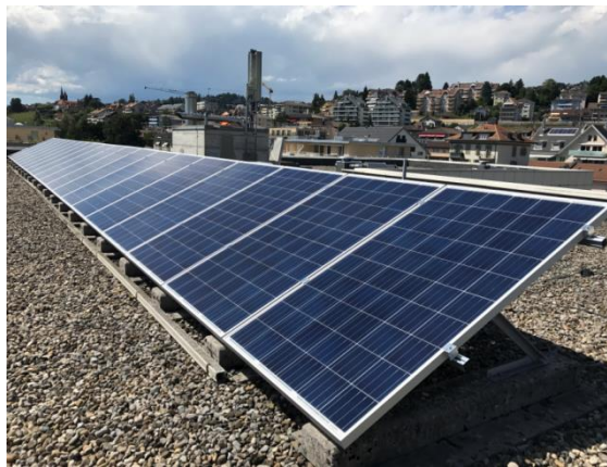
Nouvelle installation photovoltaïque de la Damataire (5.3 kW)
