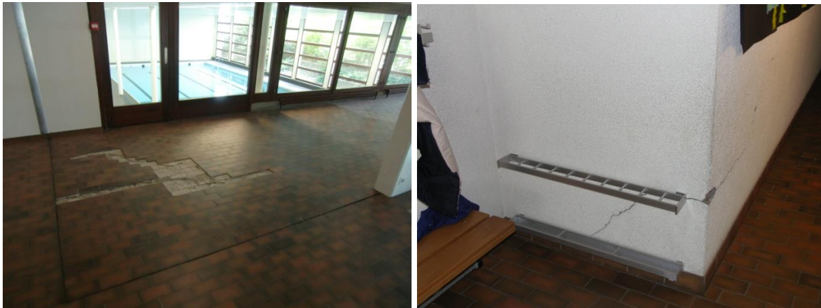
décollement du carrelage du sol
