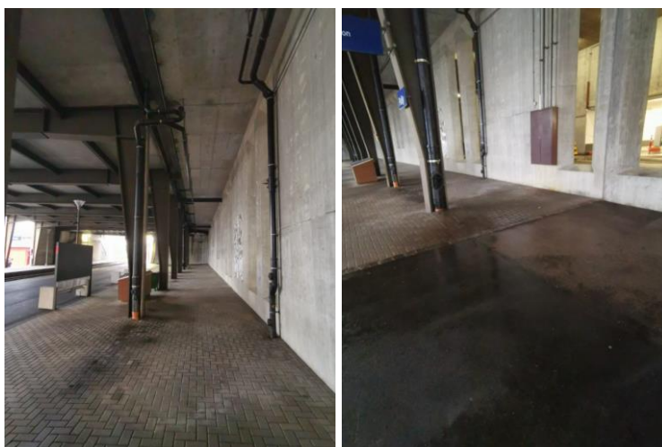
Ecoulement des eaux sur les quais CFF
