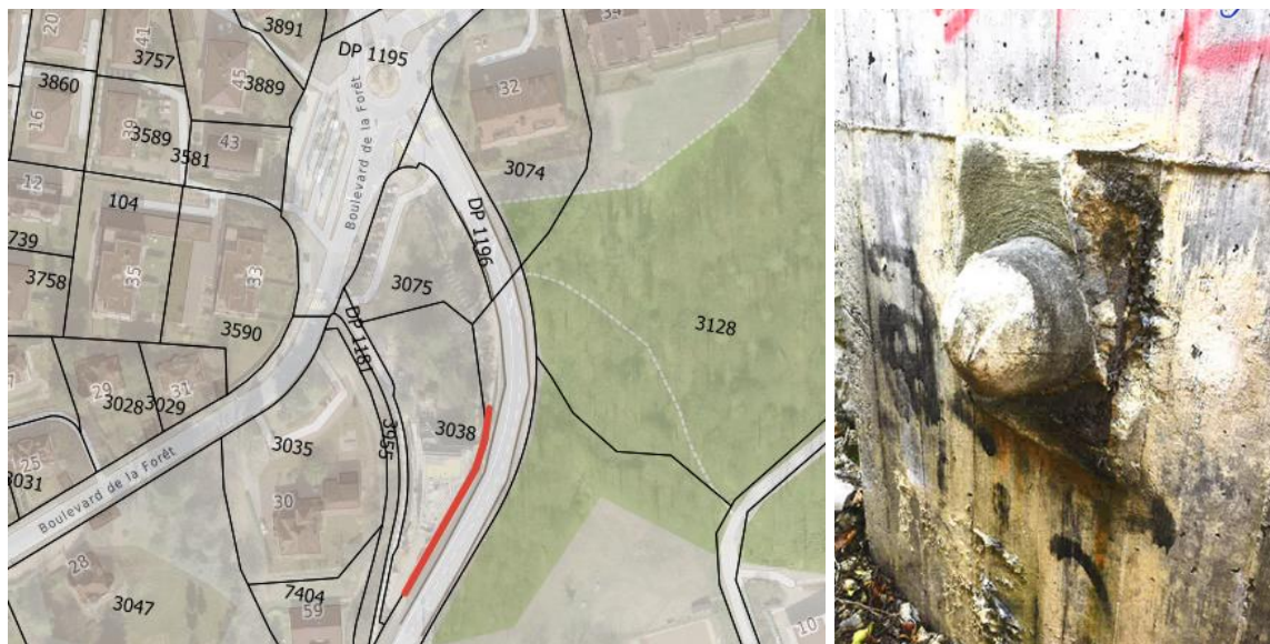
Situation et vue du mur de soutènement détérioré
