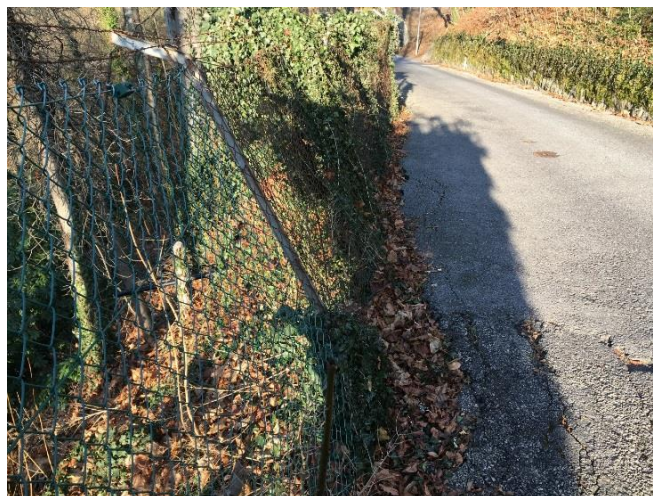
Affaissement de la chaussée au ch. de Pierraz-Portay
