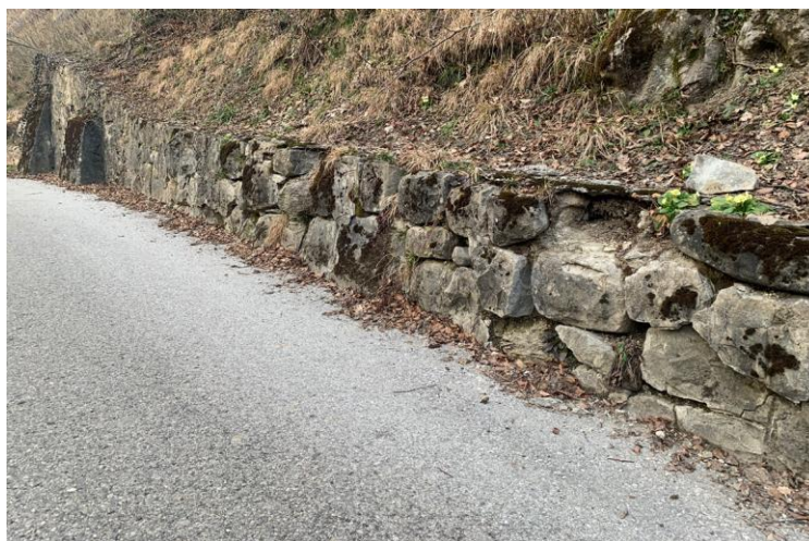
Etat détérioré du mur de soutènement
