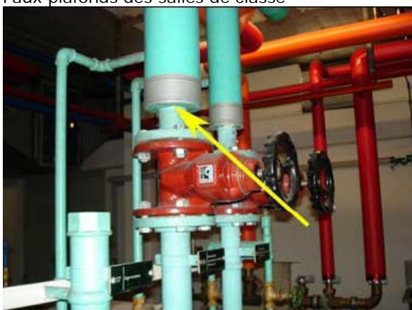
Local de la chaufferie
