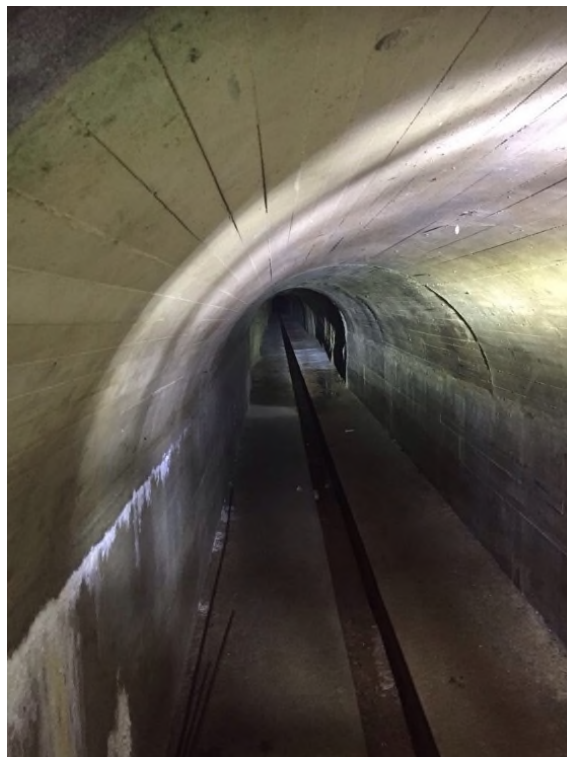
Figure n°7 : galerie de drainage de la Chenaula
