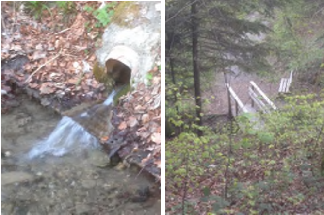
Figures n°1 et n°2 : Exutoire d'un drainage et pont sous la RC
