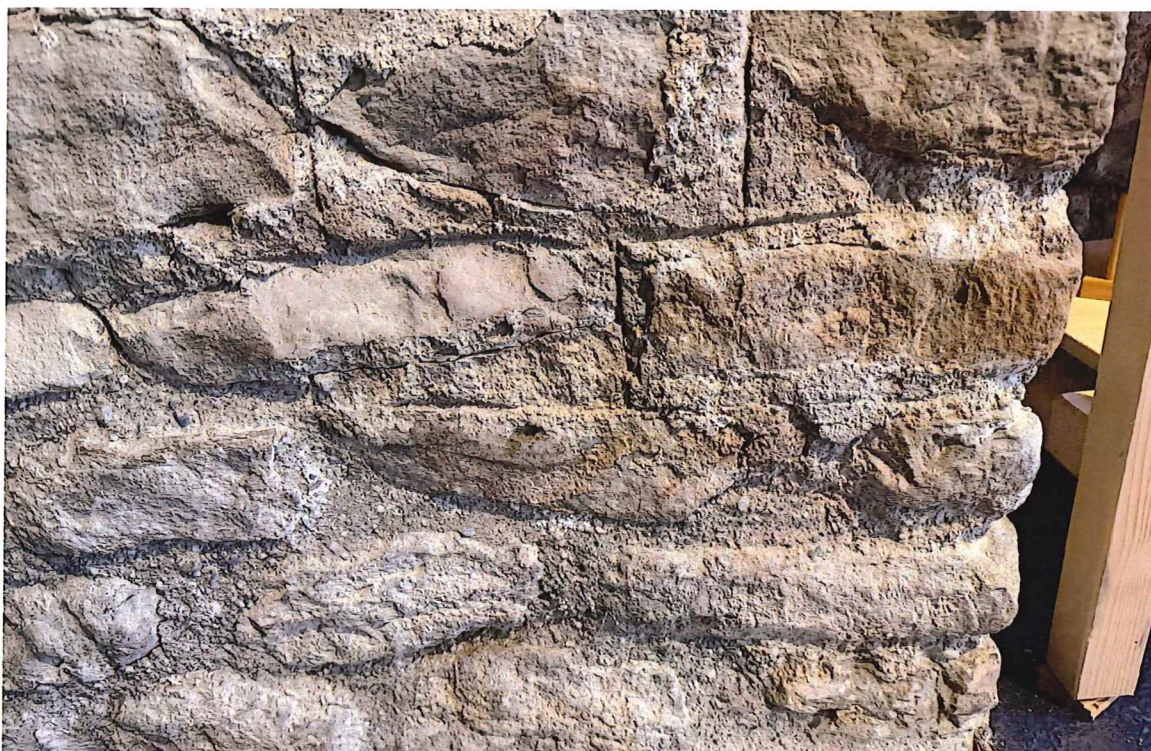
Détail des joints romains incisés et le crépi d'assainissement des années 1980 sur la partie inférieure actuellement couvert de sels blanchâtres cristallisés.
